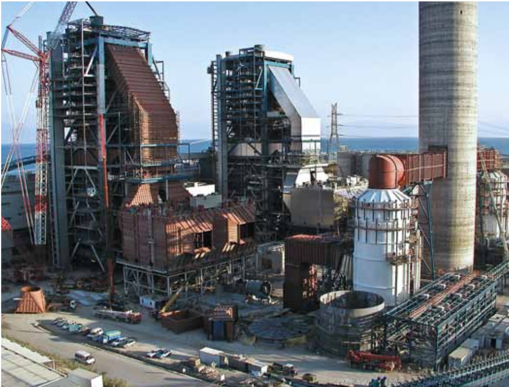
Diverse Kompensatoren in der Rauchgasentschwefelungsanlage eines Braunkohlekraftwerks DN 80 – DN 900
