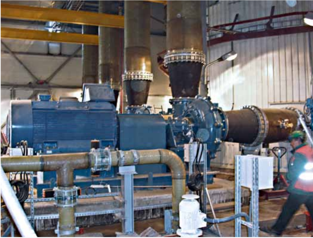
Universalkompensator Typ U300A-konz an den Pumpen einer Rauchgasentschwefelungsanlage Druckseite: DN 900 / DN 600, 4,5 bar; Saugseite: DN 900 / DN 700, 4,5 bar
