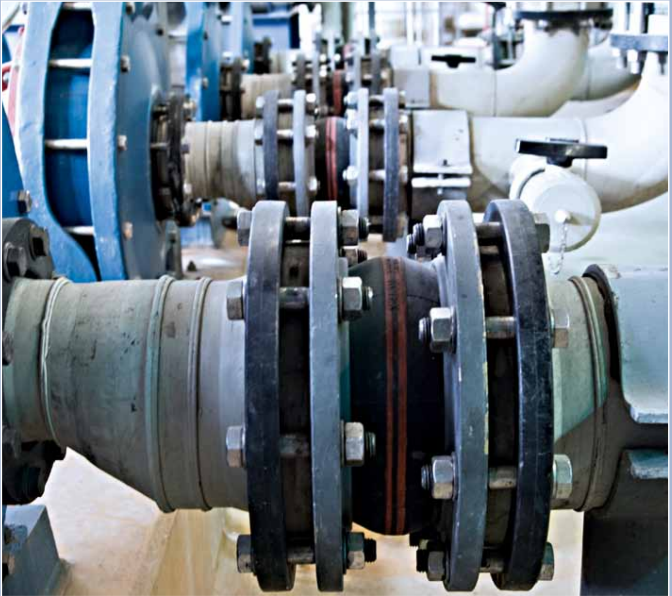
Universalkompensator Typ D100A auf der Saugseite von Löschwasserpumpen in einer Müllverbrennungsanlage DN 150, 16 bar
